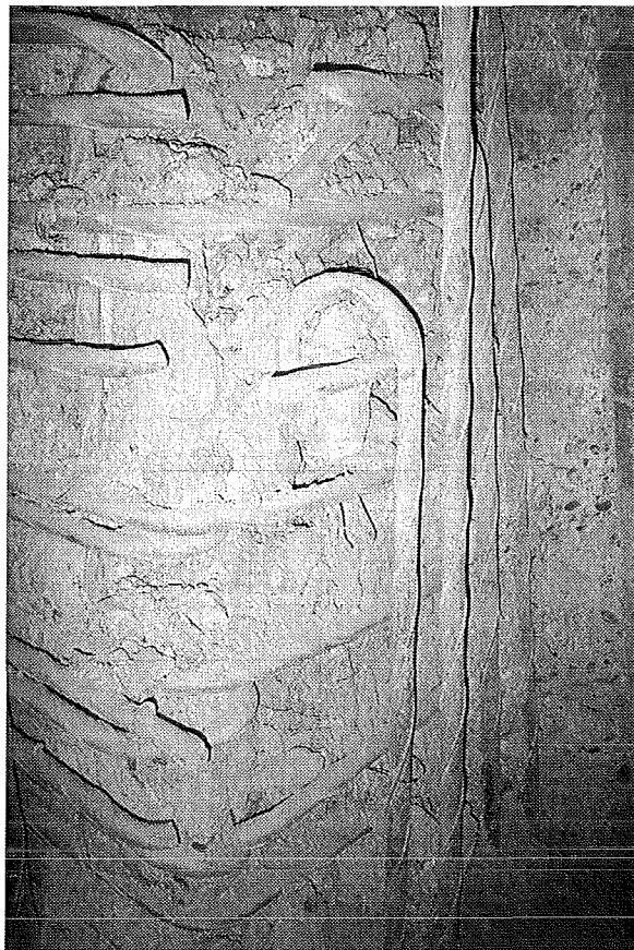
Abb. 10: Durch erste Kalibriersprengung am Absetzbecken freigelegte Bewehrung
