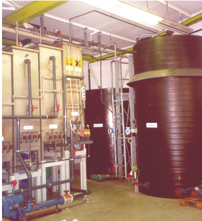
Abbildung A3: Technische Versuchsanlage bei DaimlerChrysler in Gaggenau (im Bild Speichertanks für Permeat und EC-Abwasser, ZLB und FBR 1 bis 3).
