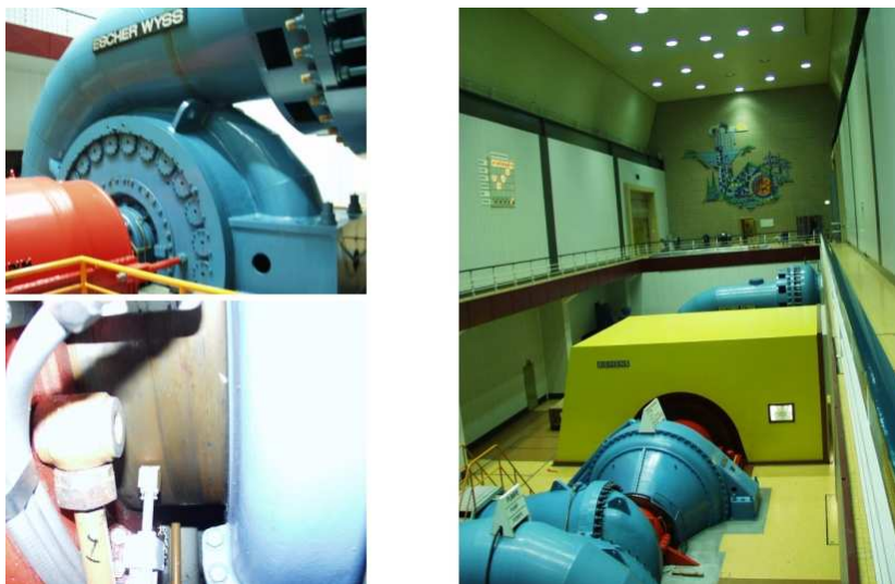
Abbildung 7.13: Kavernenkraftwerk „Wehr“: Blick in die Maschinenhalle, auf die Turbine mit Generatorkupplung und auf die Generatorwelle mit angebrachtem Sensormodul
